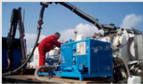
Umpumpen des Schlammes aus dem Schlammsauger über die DOD in den AVC.
